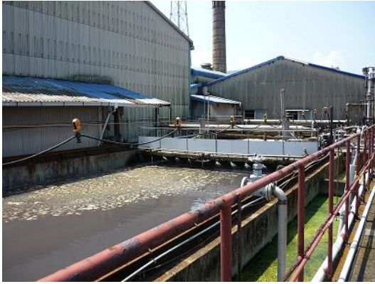
工場の屋上にある排水処理施設
