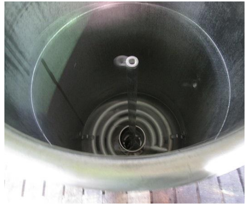
(株)日阪製作所製の大型釜の中の様子
