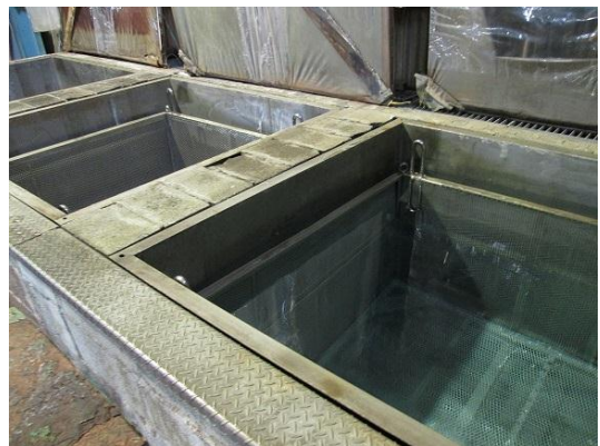
翹抜き槽の中
